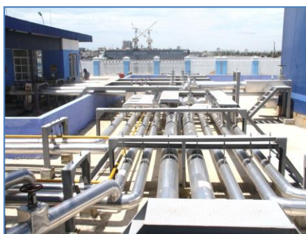
Hệ thống đường ống
