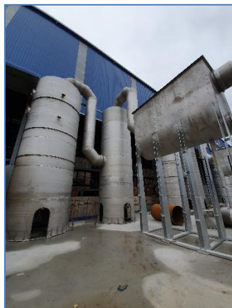
Hệ thống xử lý khí
